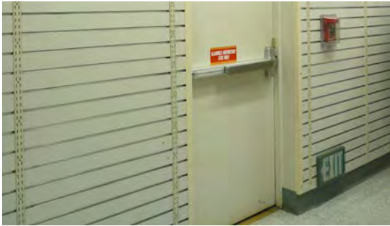
Salida de emergencia con dispositivo antipánico, buena señalización y botón de activación de alarma de incendio a altura adecuada.
