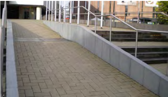
Rampa alternativa a escalera en recinto de mucha afluencia de público. En este caso la rampa es preferida por el público en general.
