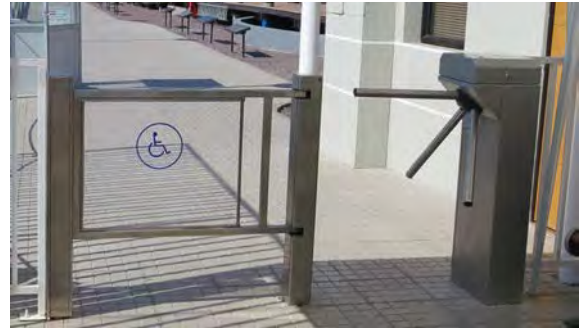
En accesos donde es necesaria la instalación de torniquetes es imprescindible contar con un paso libre de obstáculos para sillas de rueda.
