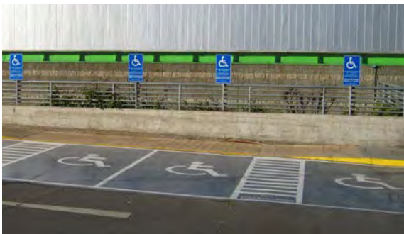
Estacionamiento de buenas dimensiones, demarcación y señalización vertical. Las franjas intermedias guían la circulación hasta a vereda rebajada.
