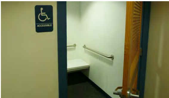
Probador accesible con barras de apoyo y asiento para facilitar su uso a personas con movilidad reducida en tiendas.
