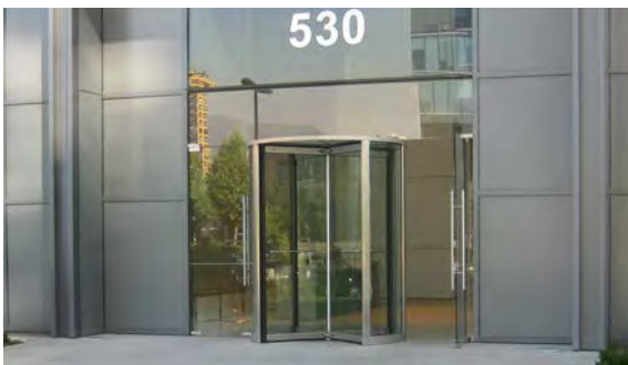
Una puerta giratoria no se considera accesible. Debe existir siempre la alternativa de una puerta de tipo batiente.
