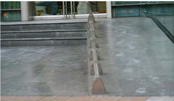
Toda rampa requiere por seguridad una protección lateral para impedir la caída accidental de una silla de ruedas o coche de niños.
