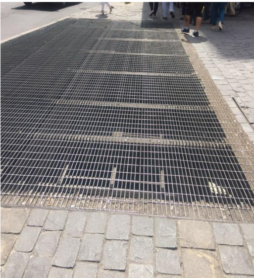
Rejillas actuales frente Teatro Municipal – Ancho entre rejilla 2,5cm
