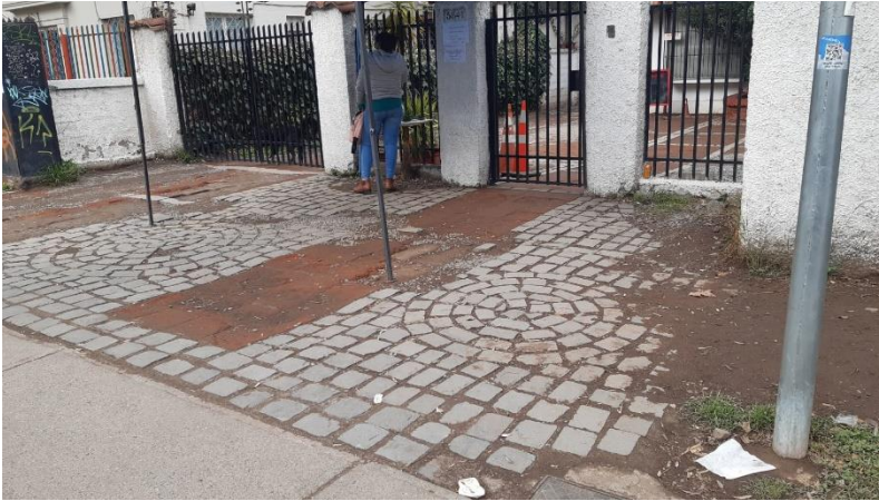
Acceso exterior, ladrillos en mal estado y pavimento de adoquines inaccesible
