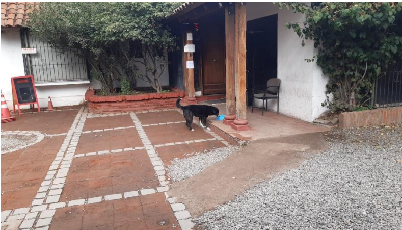
Entrada inaccesible. Tramo que simula una rampa salva primer desnivel existiendo un peldaño adicional en el acceso.
